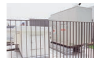
大型自家発電機
