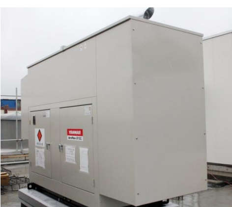
新校舎屋上にある大型自家発電機。これによって、停電に見舞われた際も、校舎内の電力を確保することができる。
