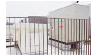
大型自家発電機
